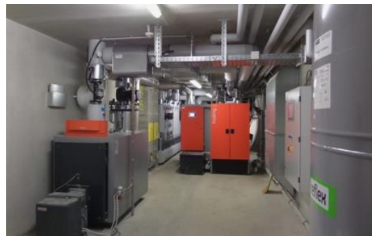
Heizraum mit Kesseln
