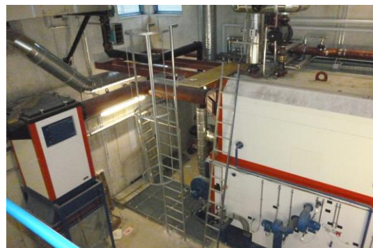
Oben: Innenansicht Heizhaus auf den Hackschnitzelkessel
