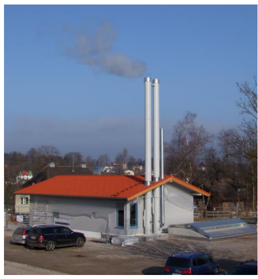
Biomasseheizwerk „Waitzinger Wiese“
