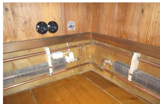
Lamellenheizleisten unter der Eckbank
